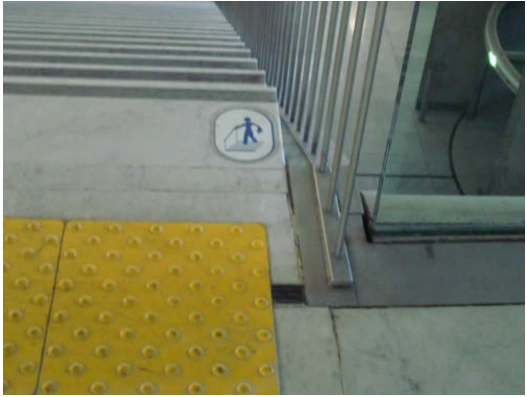
Imágen CA 05 - 1 Escaleras con franja de advertencia
